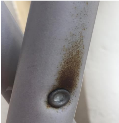
Ilustración 18: Corrosión por picaduras
