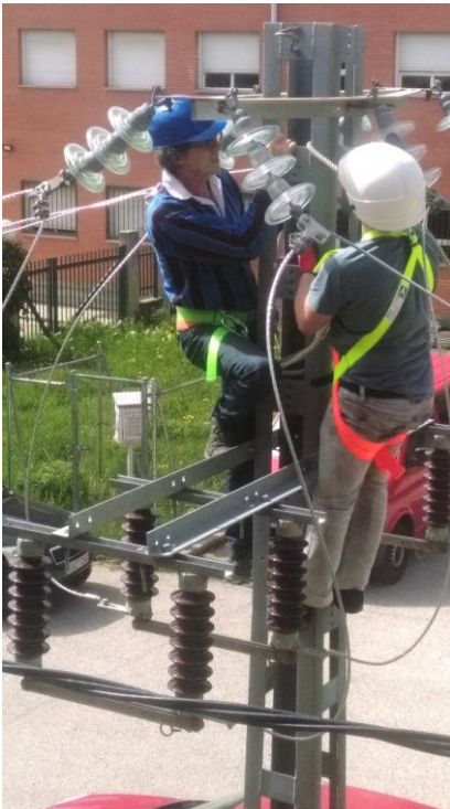
AULA EXTERIOR DE MEDIA TENSIÓN
