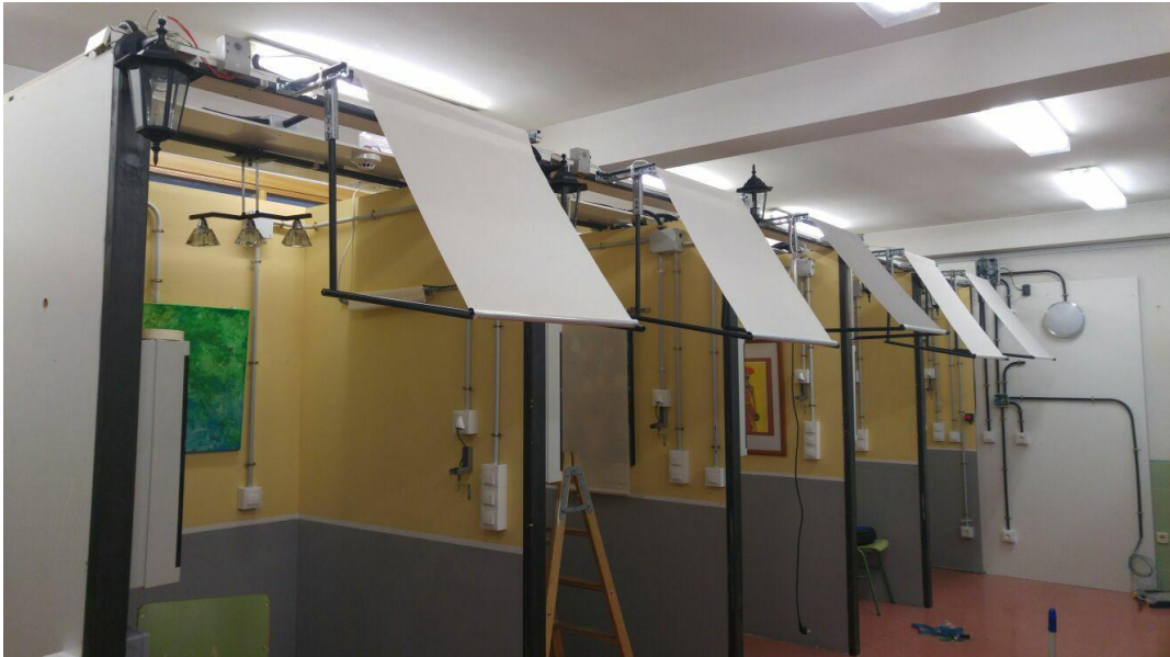
AULA DE CABINAS PARA INSTALACIONES ELÉCTRICAS INTELIGENTES (DOMÓTICA)
