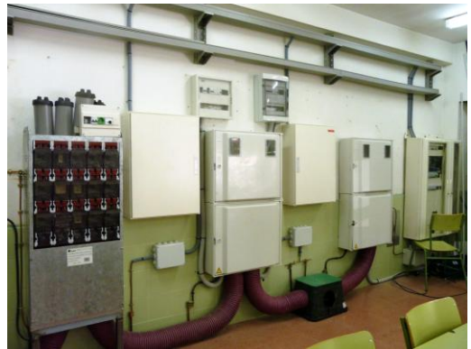
AULA DE REDES DE DISTRIBUCIÓN EN BAJA TENSIÓN
