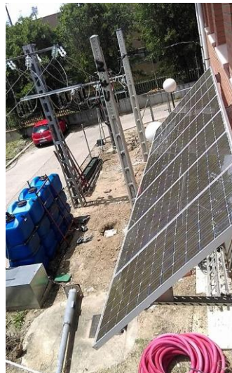
ENERGÍA SOLAR FOTOVOLTAICA
