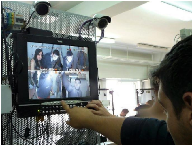
CIRCUITO CERRADO DE TV SOBRE IP
