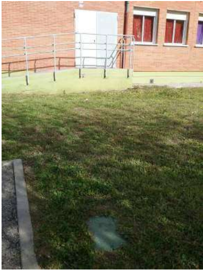
Boca de Riego junto a caldera Módulo Principal
