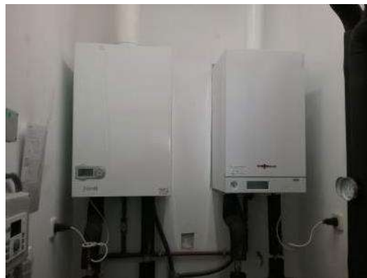
Caldera de Módulo 3º Ciclo
