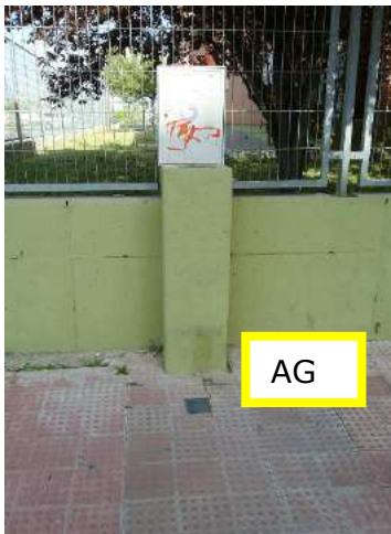
Acometida de Gas.
