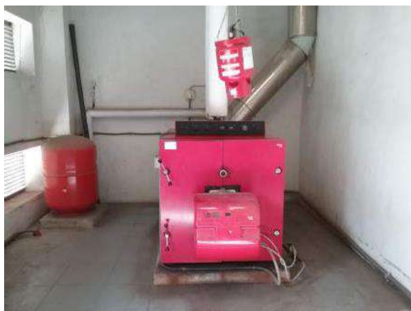
Caldera Módulo Principal
